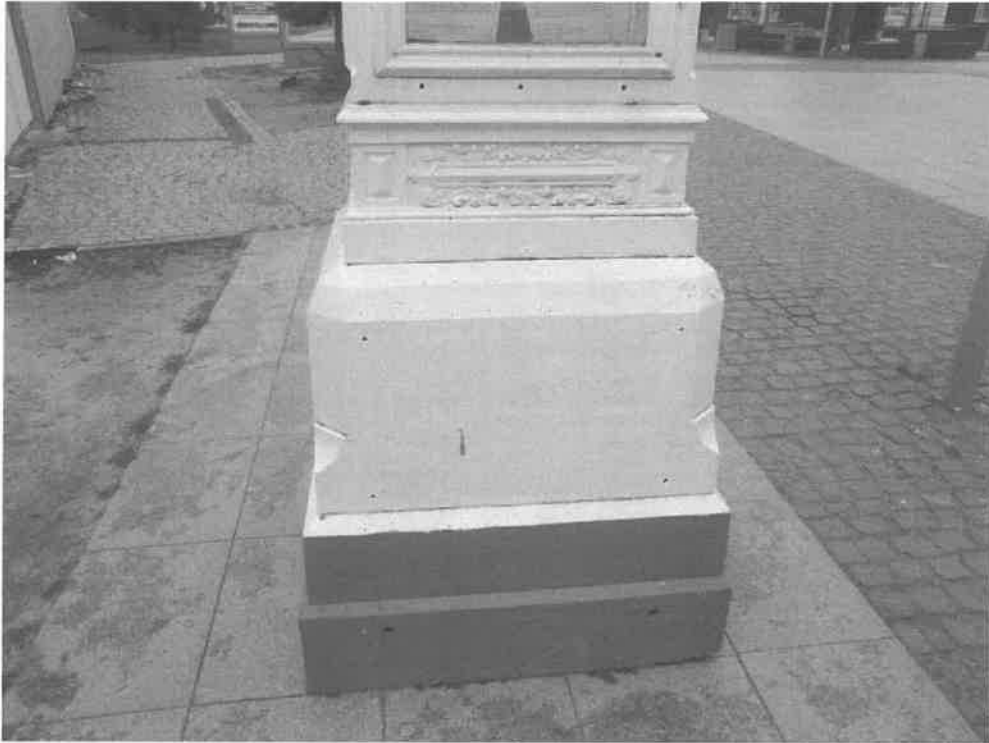
Fot.9. Spękanie w dolnej część cokołu.
