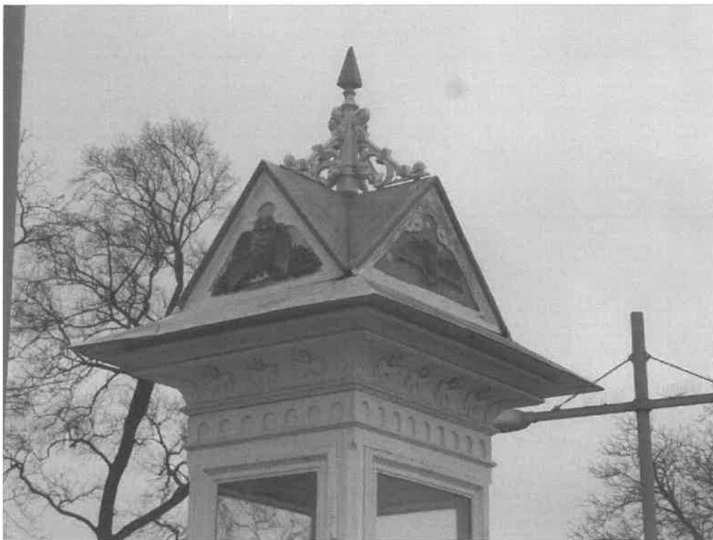
Fot.4. Powierzchnia daszku pokryta nalotem alg. Widoczne spękanie w narożniku.
