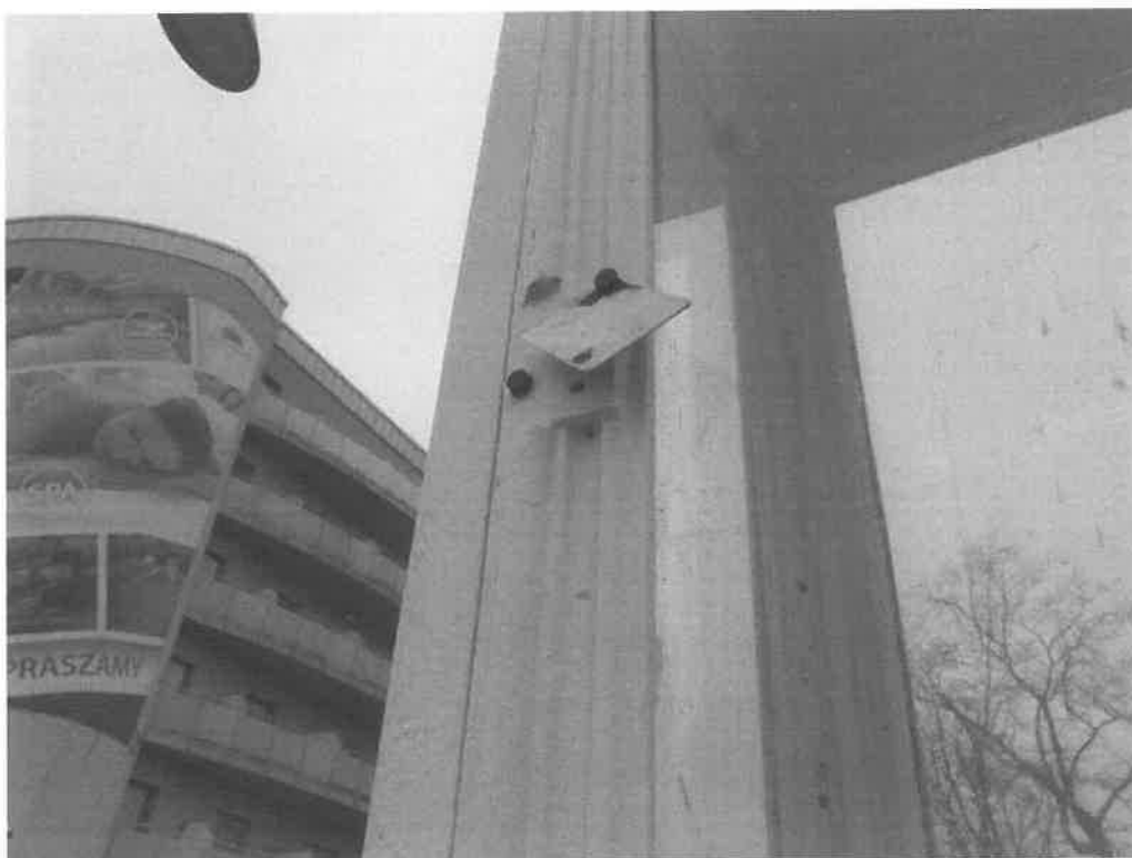
Fot.7. Skorodowane śruby.
