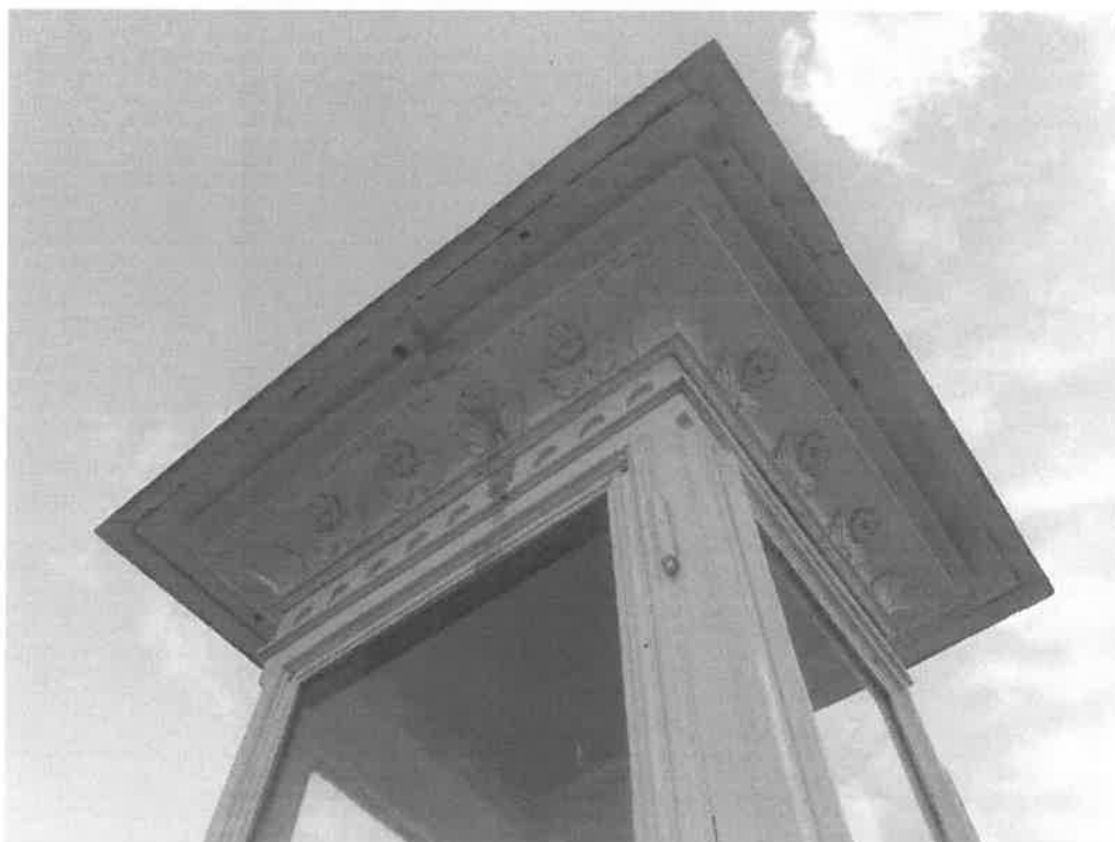
Fot.3. Narożnik daszku ze spękaniem. Korozja widoczna szczególnie w miejscach połączeń.
