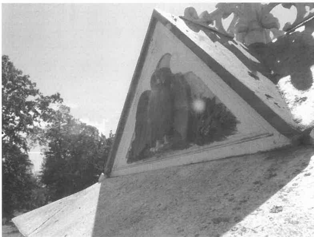
Fot. 5. Daszek z nalotem porostów. Na połączeniach między połaciami korozja.
