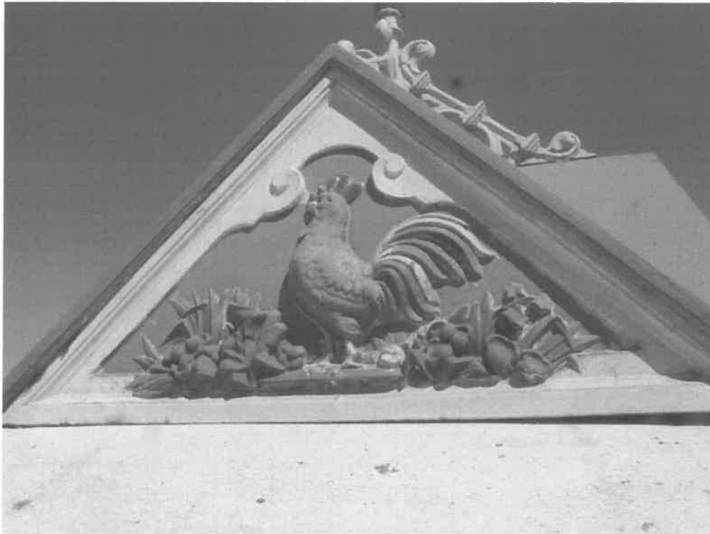
Fot.5. Ogniska korozji na powierzchni daszku, widoczne szczególnie na krawędziach. Nieszczelność przy łączeniu połaci z naczółkiem.
