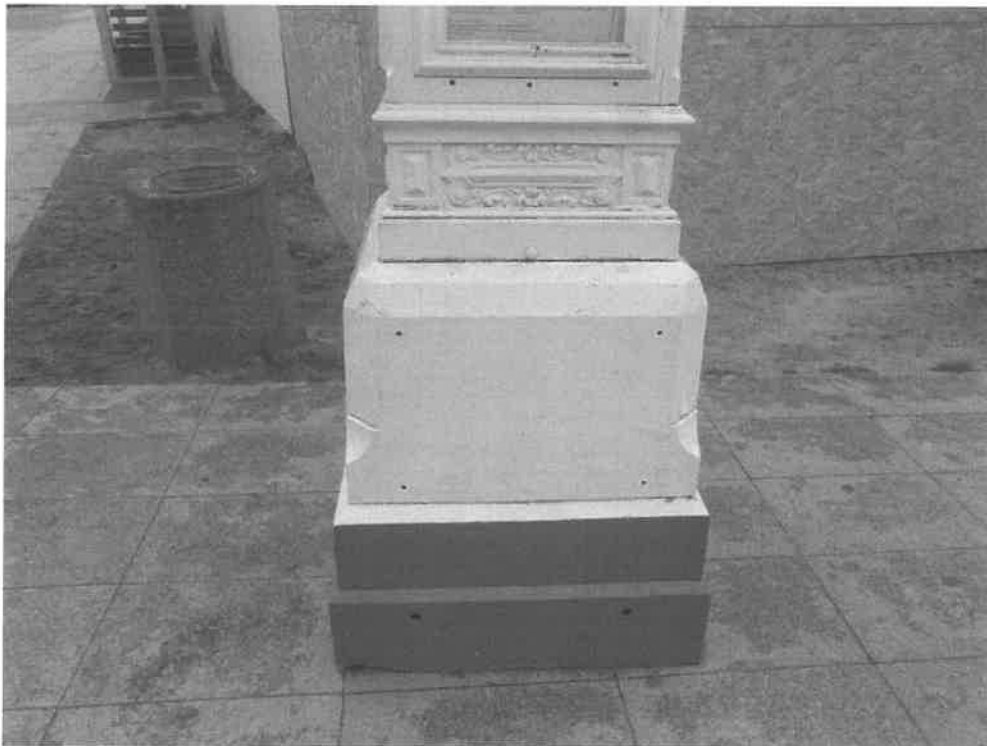
Fot. 10. Ubytek na dole cokołu
