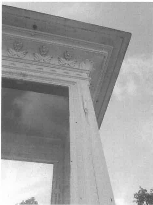
Fot.2. Złuszczona farba i korozja widoczna od spodu daszku i przy zawiasach.
