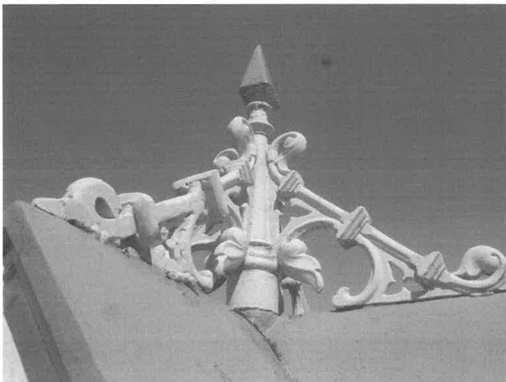
Fot. 12. Zwieńczenie wielokrotnie przemalowywane z widocznymi naprawami i ubytkami w jednej z podstaw. Farba na daszku łuszczy się.
