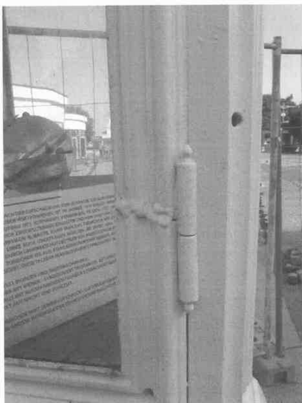
Fot. 8. Nieestetycznie wykonana naprawa ramki drzwiczek do gabloty. Przy szybie widoczne ogniska korozji.
