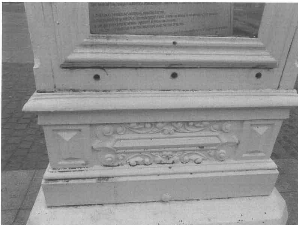
Fot.6. Wokół otworów widoczne produkty korozji.
