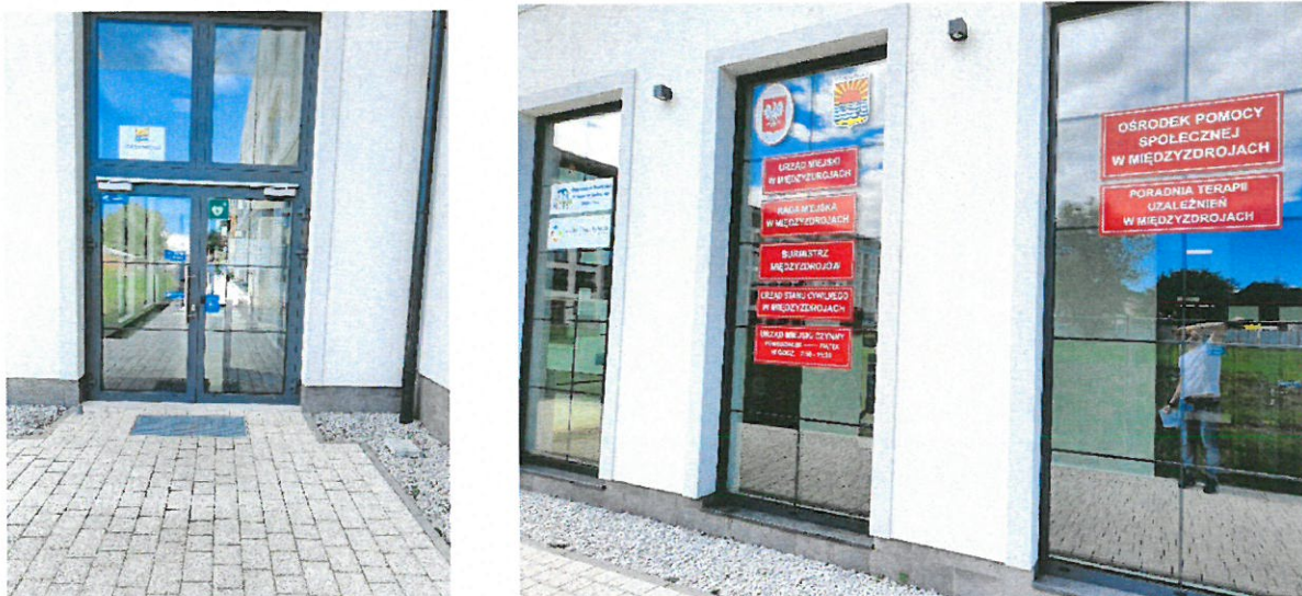
Foto. 5, 6 Słabo oznaczone wejście główne oraz nieprawidłowo umieszczone tablice informujące o przeznaczeniu obiektu.
